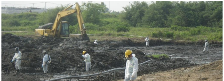
Đào xức bùn nhiễm bẩn ở khu vực phía tây Hồ Sen
