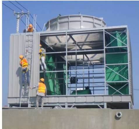
Tháp làm mát của hệ thống xử lý chất lỏng/hơi (Ảnh: CDM Smith)
