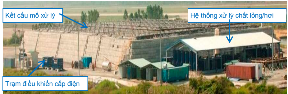
Kết cấu móng xử lý và hệ thống xử lý chất lỏng/hơi
