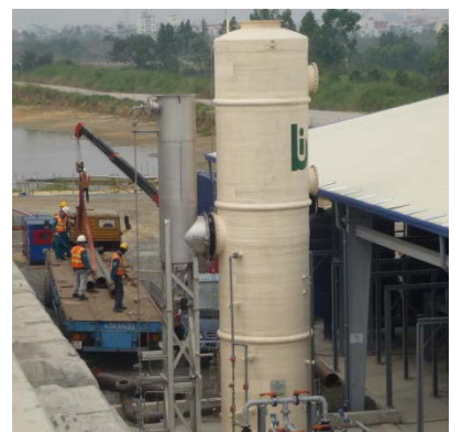
Tháp làm mát nhanh của hệ thống xử lý chất lỏng/hơi (Ảnh: CDM Smith)
