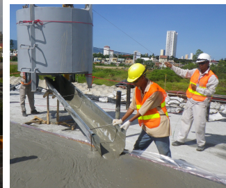
Đổ các lớp bê tông lên bề mặt kết cấu (Ảnh: CDM Smith)
